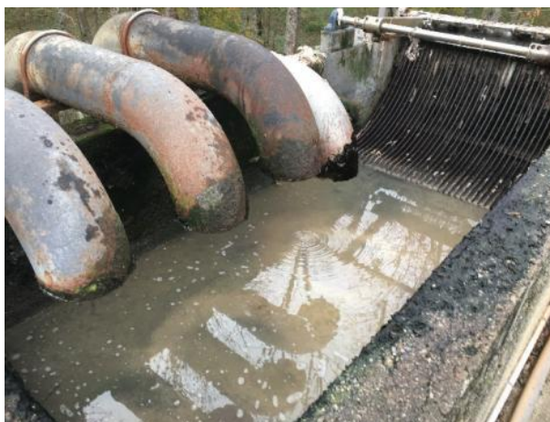
Poste de relevage et dégrilleur
