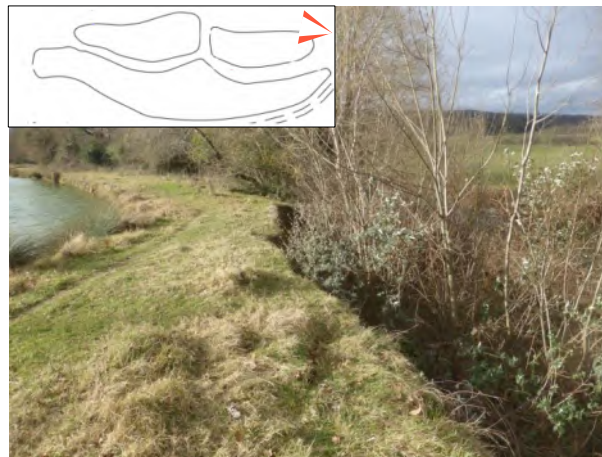
Berge entre le 2ème bassin et le ruisseau (érosion)
