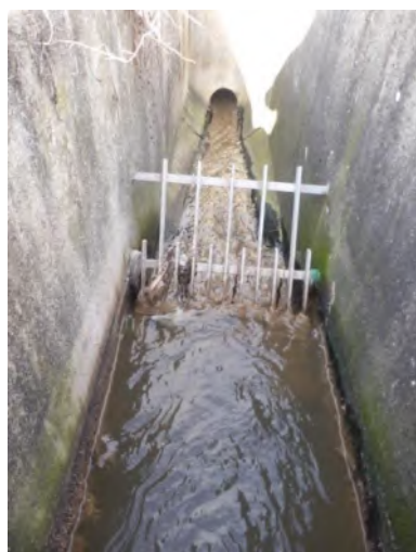
Canal d'entrée – dégrilleur manuel
