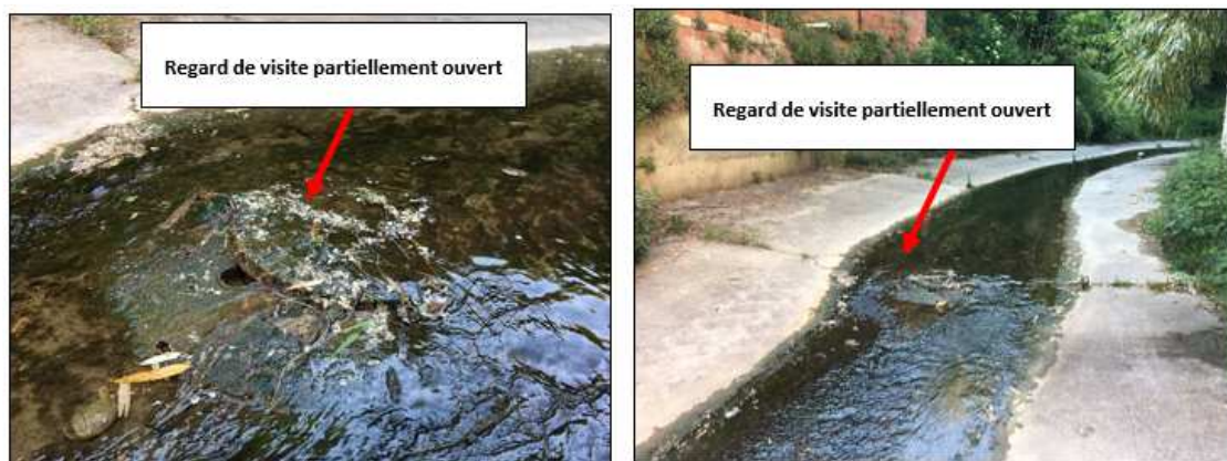
Figure 3 : Localisation du tampon de regard de visite partiellement ouvert dans le ruisseau de l'Ansonne
