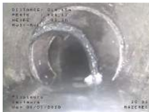
Anneau d'étanchéité défectueux
