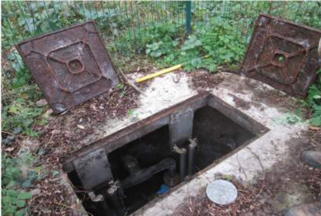
Accès à la bache humide
