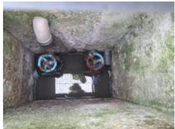
Regard de vidange et de drainage des cuves
