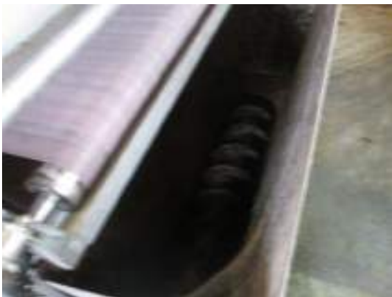
Chute des boues dans pompe gaveuse
