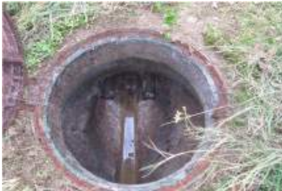
Accès à la bache humide
