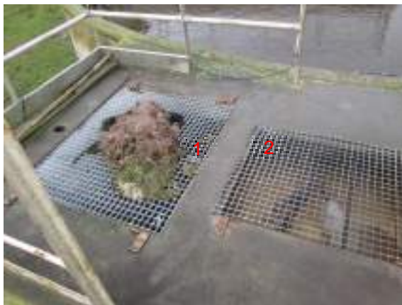
1 : Poste de recirculation
