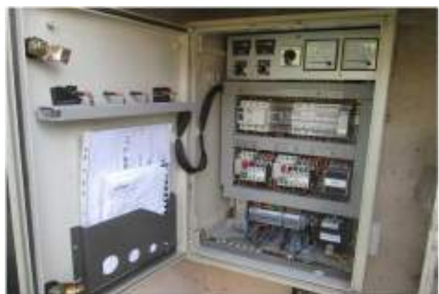
Intérieur de l'armoire électrique
