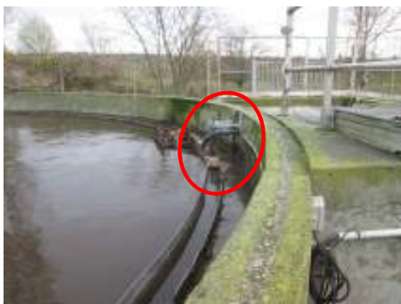
Prise d'eau industrielle
