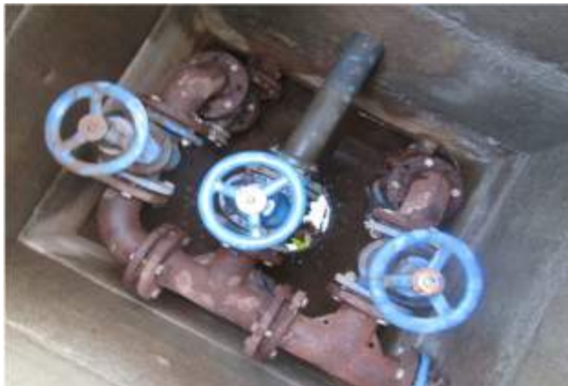
Intérieur de la chambre à vannes
