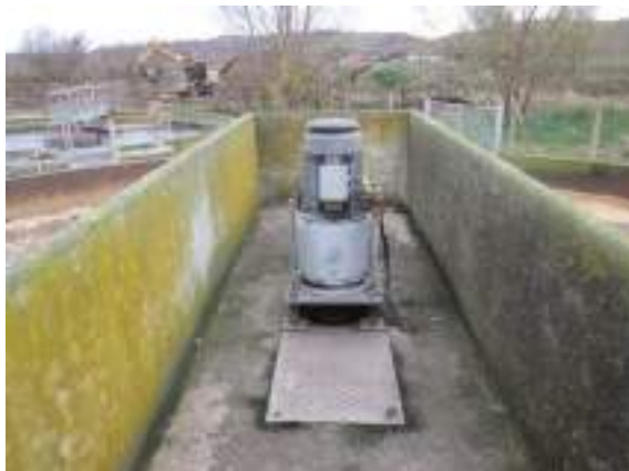
Motoréducteur de la turbine de surface
