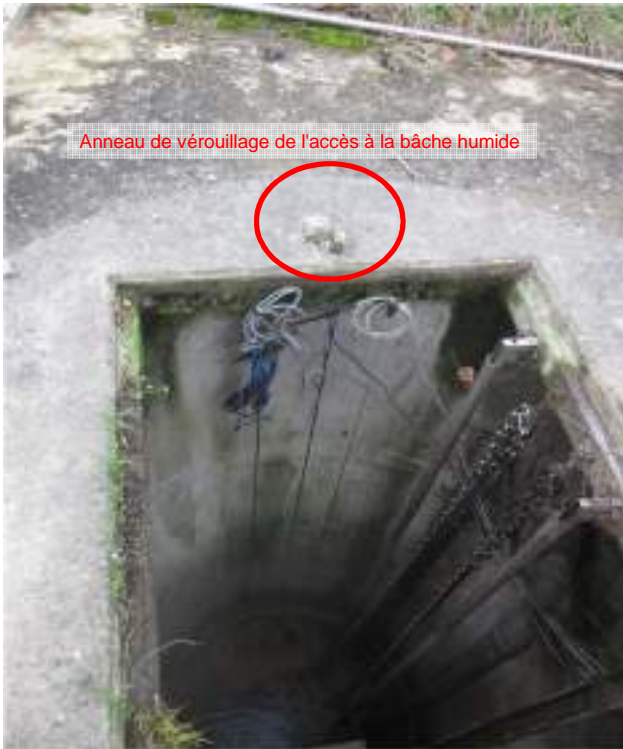
Accès à la bache humide
