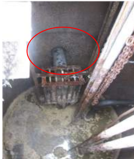
Intérieur du PR - Lixivation du béton au niveau de la chute d'EU
