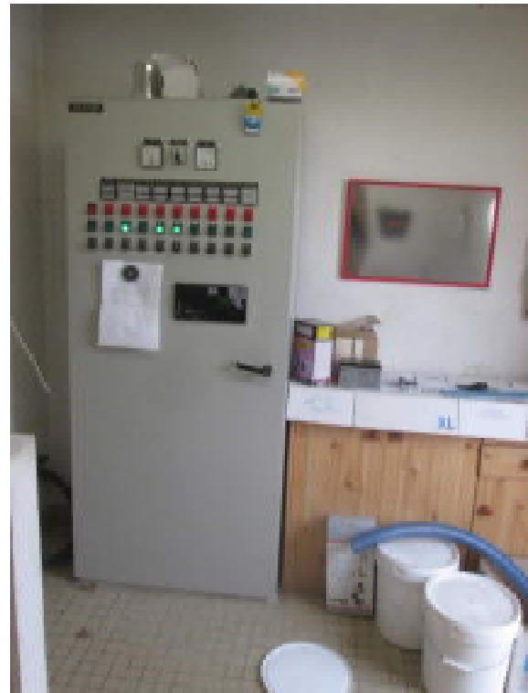
Armoire électrique générale de la STEP
