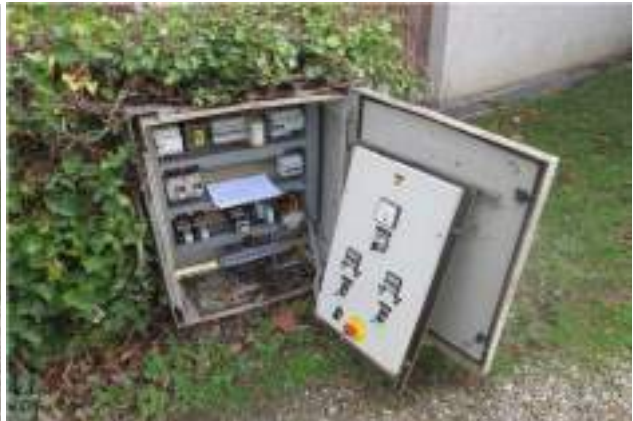
Intérieur de l'armoire électrique
