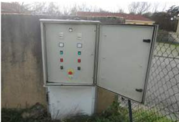
Partie commande de l'armoire électrique générale
