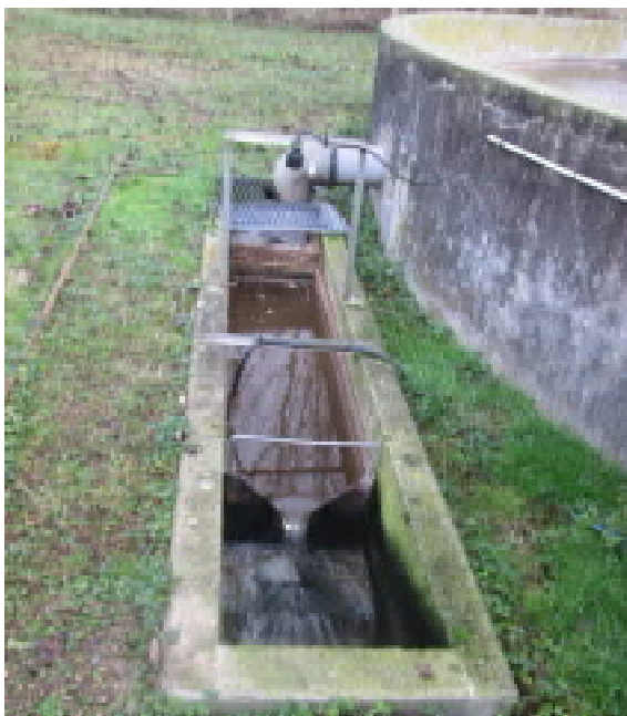
Canal débitmétrique en sortie
