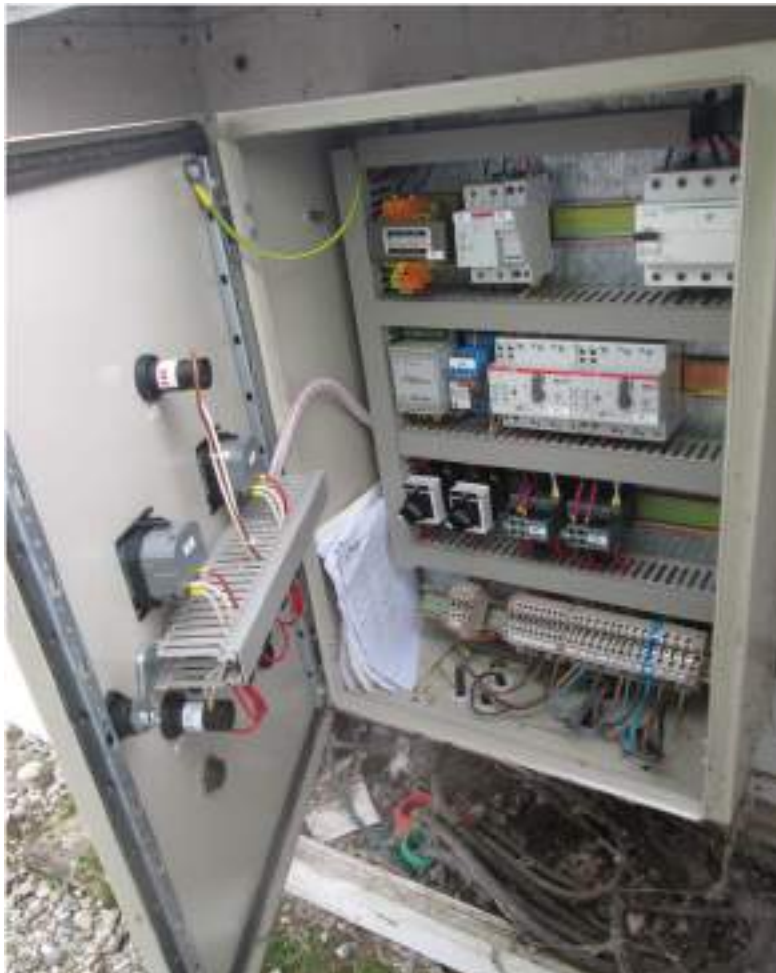
Intérieur de l'armoire électrique
