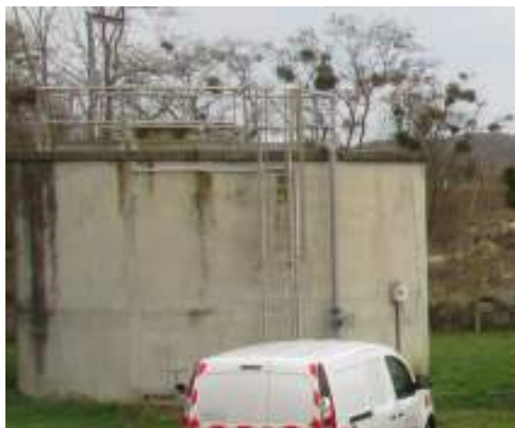
Silo de stockage des boues
