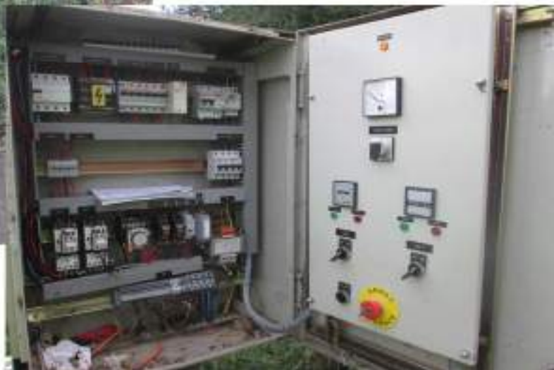
Intérieur de l'armoire électrique
