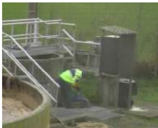
Caisson de protection du préleveur et conteneur à refus de dégrillage
