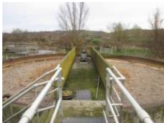
Passerelle d'intervention du BA
