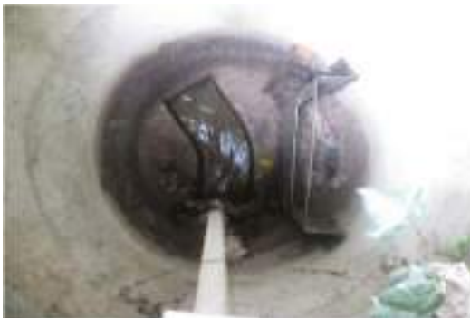
Regard amont PR : TP + Vanne d'isolement
