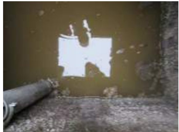
Cuve à sable
