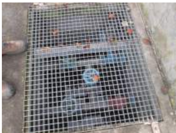
Chambre à vannes
