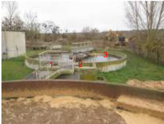
1 : Poste de recirculation
