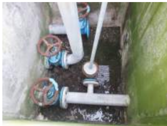
Chambre à vannes du silo
