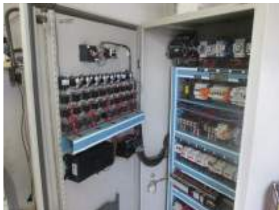
Intérieur de l'armoire électrique
