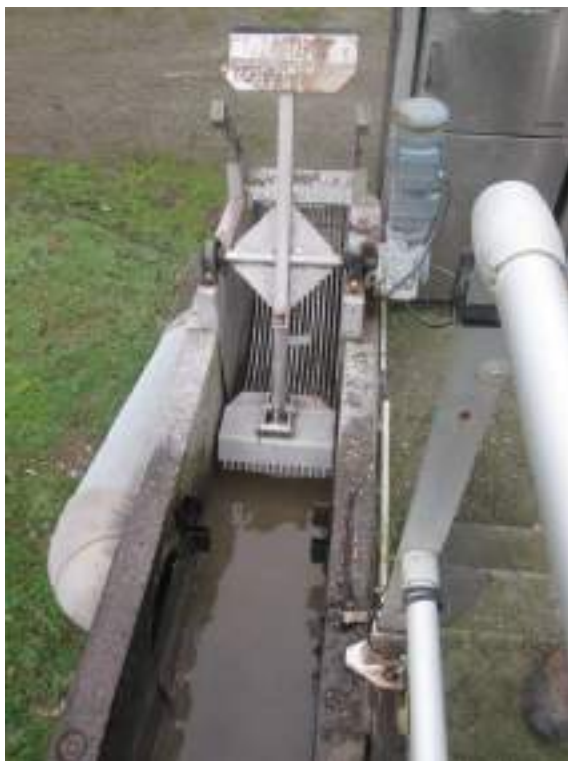
Canal dégrilleur en entrée
