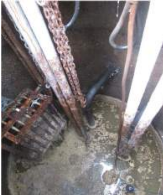
Intérieur du PR - Barres de guidage et chaîne de levage fortement corrodée
