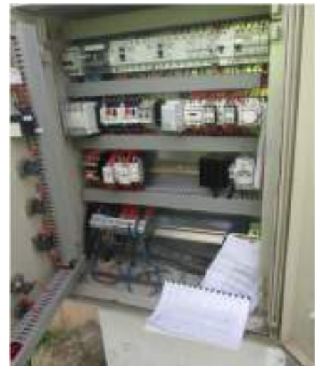
Intérieur de l'armoire électrique générale
