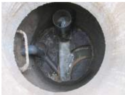
Exemple de regard avec traces de mise en charge
