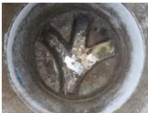
Exemple de regard avec du dépôt
