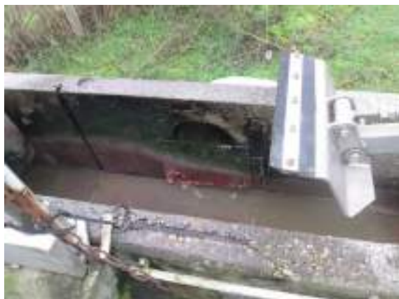
By-pass du dégrilleur à demi obturé
