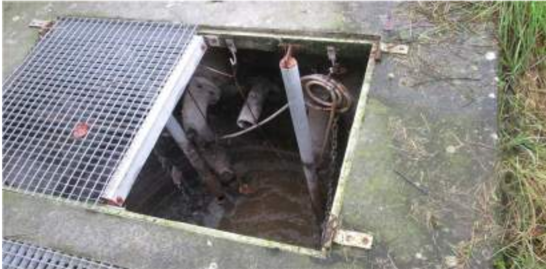
Accès à la bache humide
