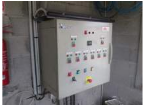
Armoire électrique de la presse
