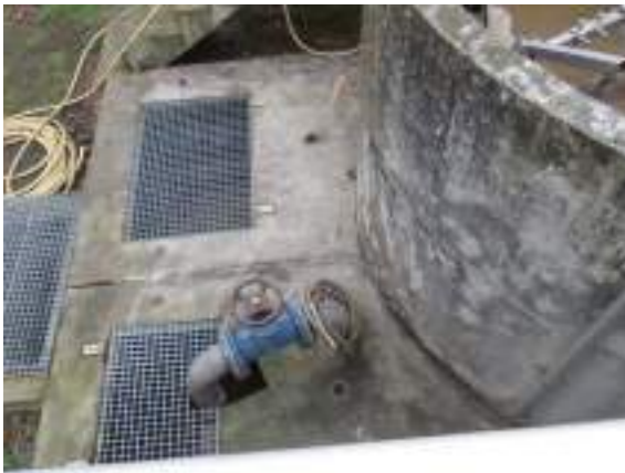
Cuves de stockage des graisses et des sables
