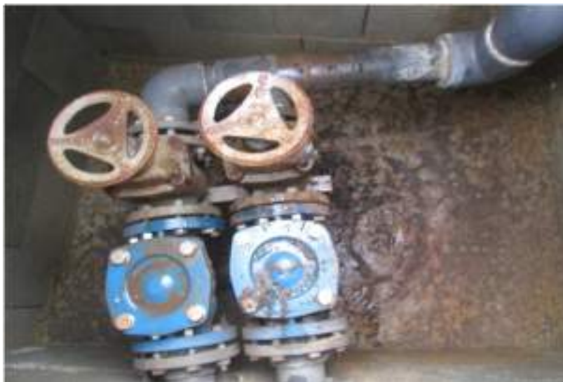
Intérieur de la chambre à vannes
