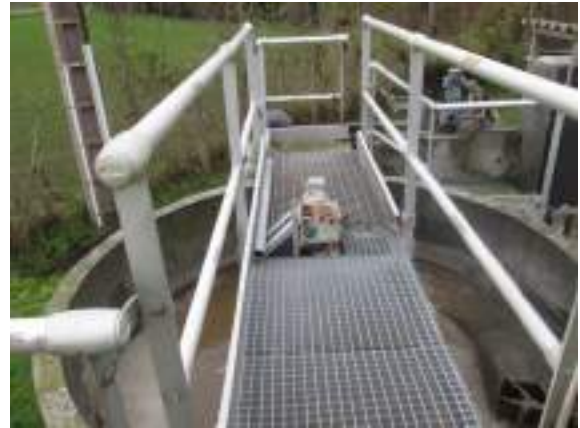
Passerelle d'intervention et de passage vers le BA
