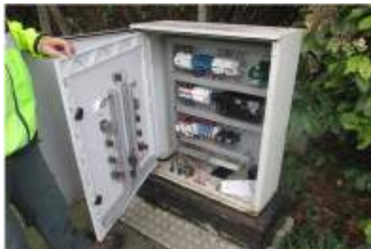
Intérieur de l'armoire électrique
