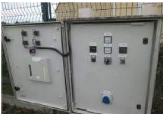
Partie commande de l'armoire électrique
