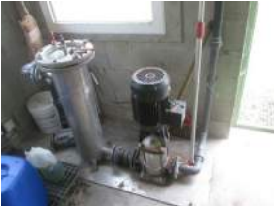
Pompe d'eau industrielle
